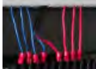
N1042835 Electrical Cable for Kiosk
